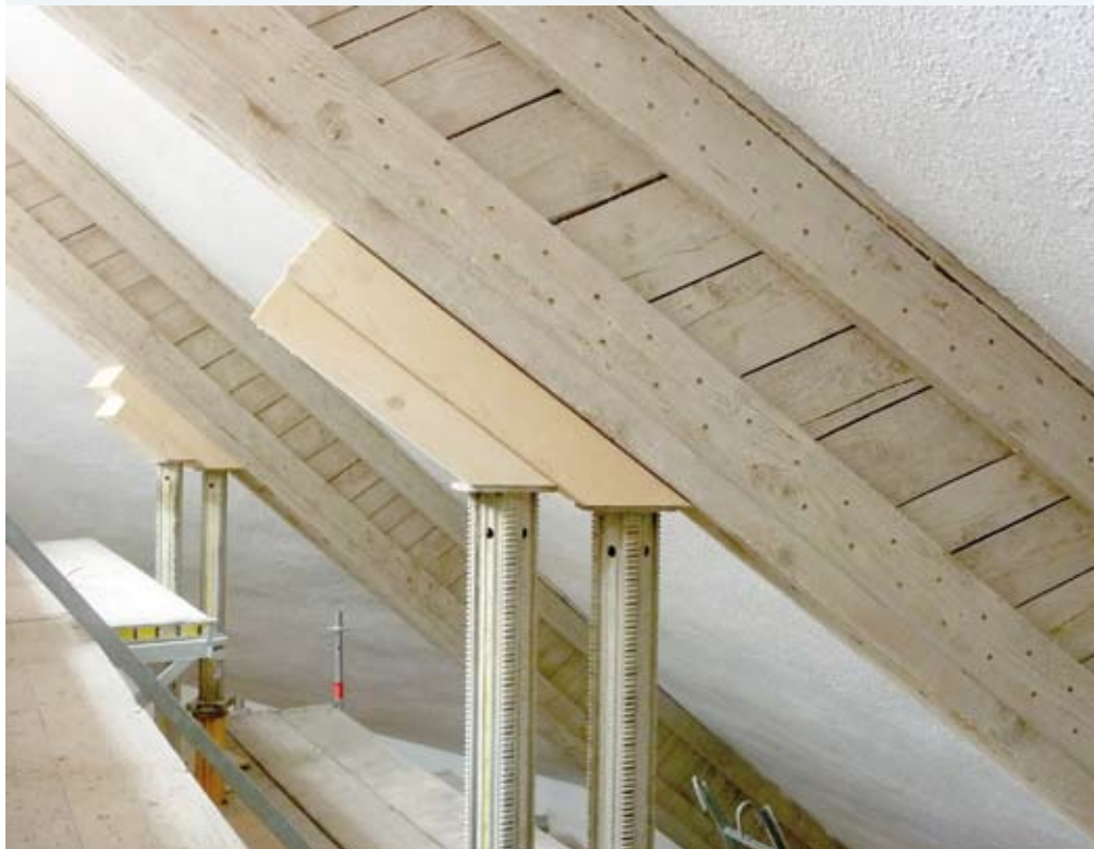
Die ehemals aus Brettern und Bohlen zusammengesetzten I-Profile wurden zunächst mittels Hubstützen entlastet und dann mit neuen Verschraubungen versehen.
